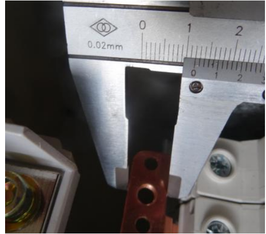
主母排宽度照片
